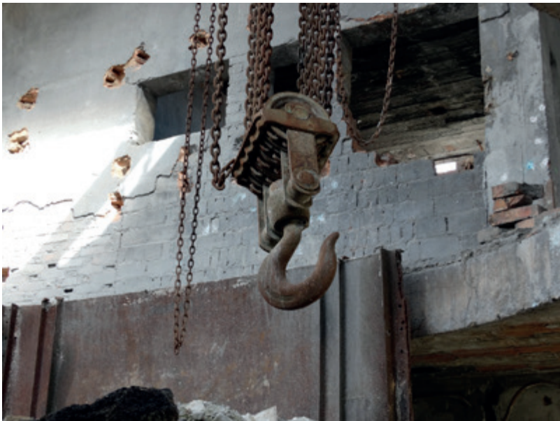
Figura 21. Ferroaleaciones – Gancho transportador del horno - oxidado. Fotografía: autor, 2016
