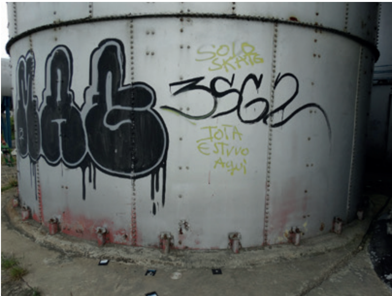
Figura 26. Silos del Idema – Estructura intervenida con grafiti. Fotografía: Autor, 2016
