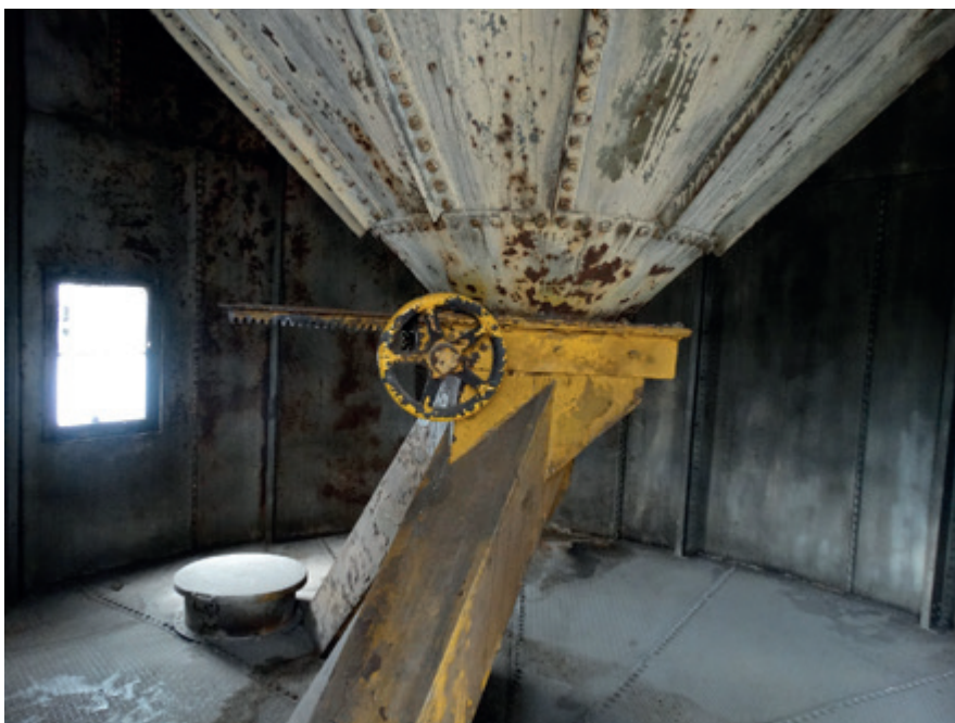
Figura 9. Silos del Idema – máquina distribuidora de grano. Fotografía: autor, 2015
